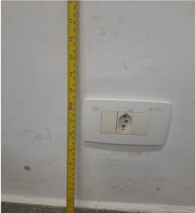
Figura 5: Tomada instalada abaixo da altura imposta pela norma. Fonte: elaborada pelos autores.
