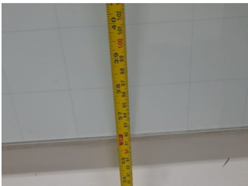
Figura 1: Lousa instaladas acima da altura recomendada. Fonte: elaborada pelos autores.
